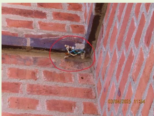
Udv. El, mangler dåse
